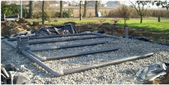
Installation d'assainissement non collectif - AEAP
